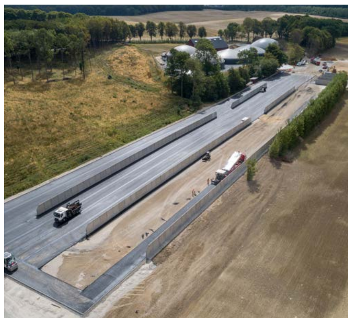
Colas udlagde asfalt på Frijsenborg Biogas' 11.000 m 2 store plansilo på blot to dage i juli måned 2018.
